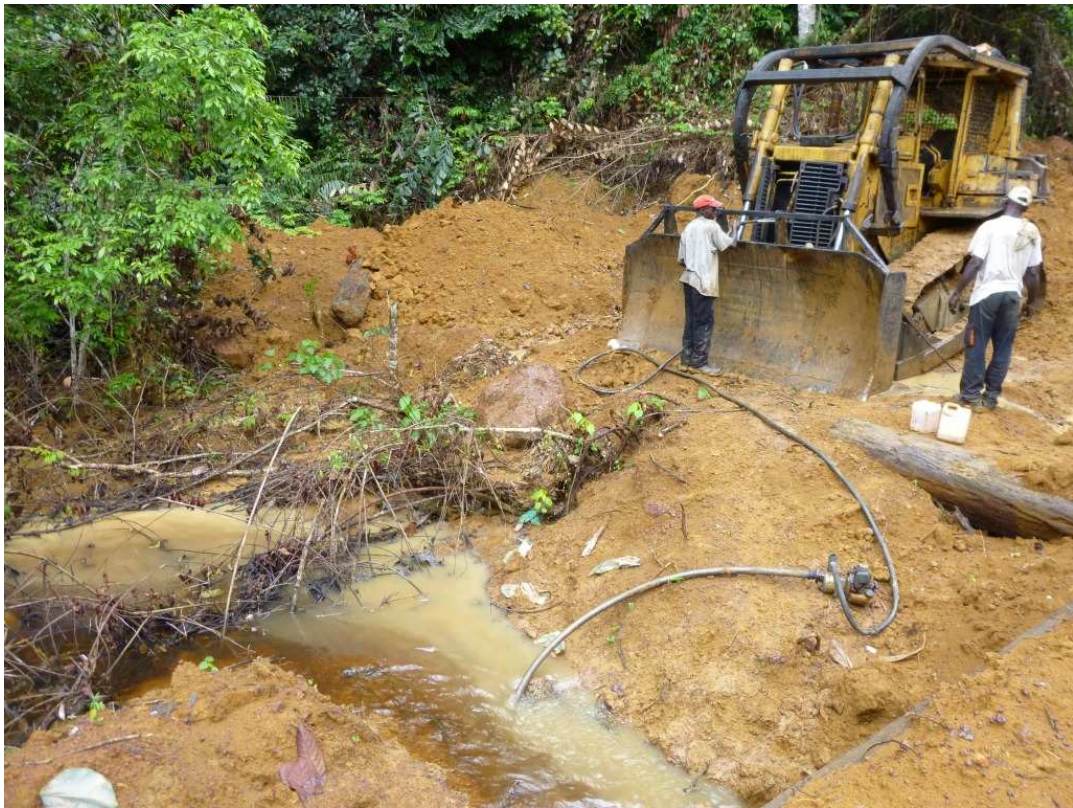
Figure 7 : Opération de lavage d'engins à proximité de cours d'eau
