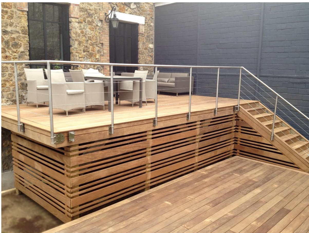
Escalier et platelage surélevé en Afrormosia - Création Terrasse Nature, Antony (France). © Terrasse Nature (photo extraite de l' Atlas des bois tropicaux 2016 )
